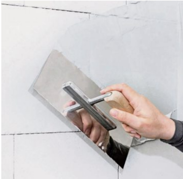
Mit dem richtigen Werkzeug lässt sich die Spachtelmasse gut verteilen. Bild: Ciret/exb
