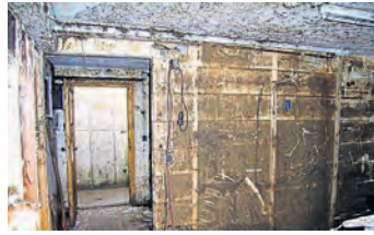
Nicht nur Schlamm bis zur Kellerdecke auch noch darüber im EG war Land unter. Bild: op
