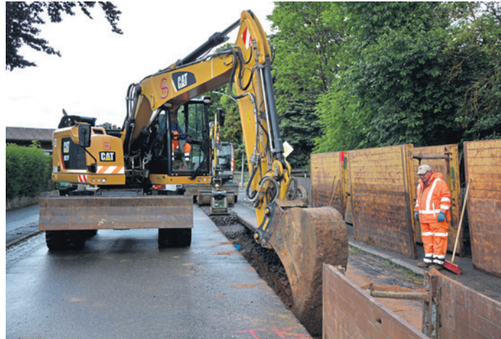
Die Bauarbeiten liegen nach Auskunft des Tiefbauunternehmens Schaumberger im Zeitplan, „wir kommen zügig voran“, war zu hören. (jr) Bild: jr
